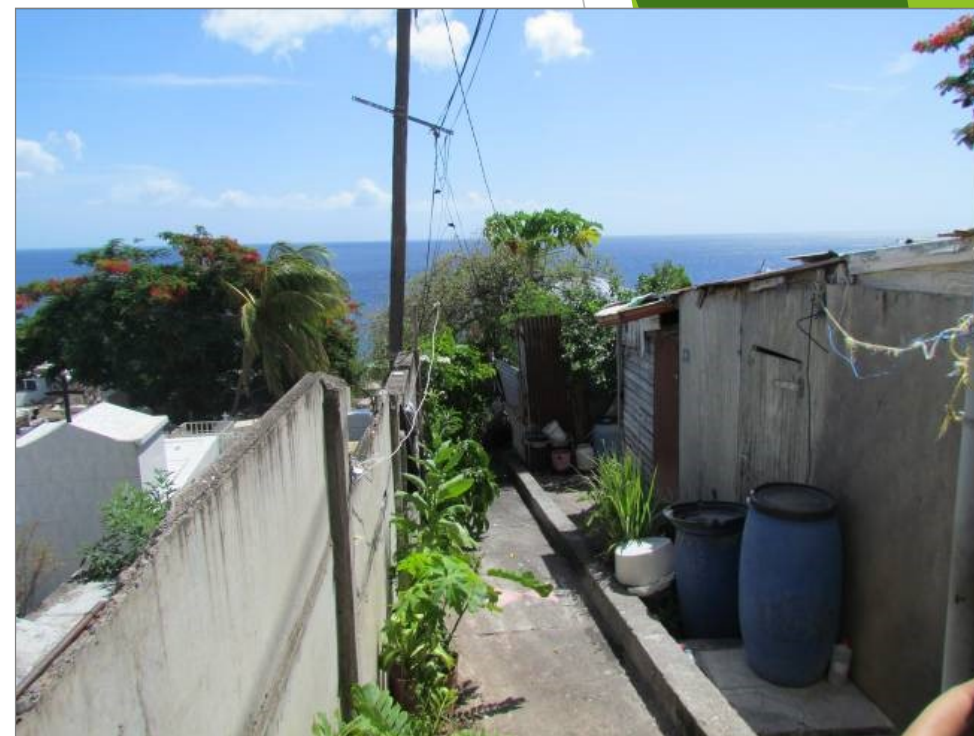
Au Nord : mur fragilisé et offrant un voisinage peu agréable (mur béton nu, très proche des habitations)
