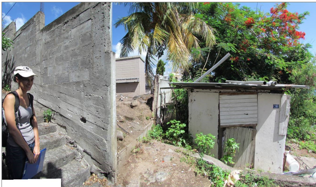
au Sud : effondrement du mur et ruissellement en période de pluie
